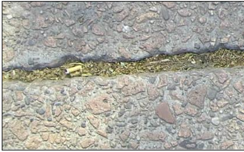
Figura 4: Degrado dei giunti non sigillati
