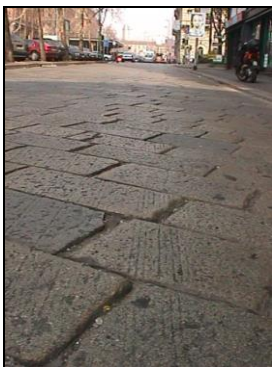
Figura 12: Eccessiva apertura dei giunti non sigillati
