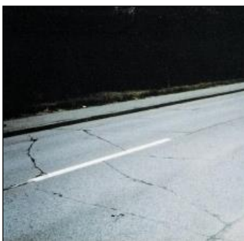
Figura 3: Esempio di fessurazione trasversale
