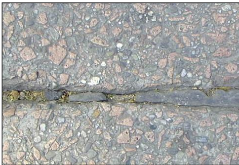
Figura 5: Degrado dei giunti precedentemente sigillati
