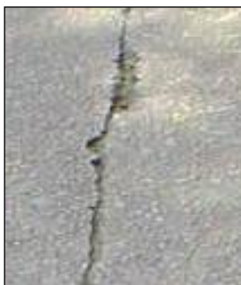
Figura 2: Esempio di fessurazione longitudinale
