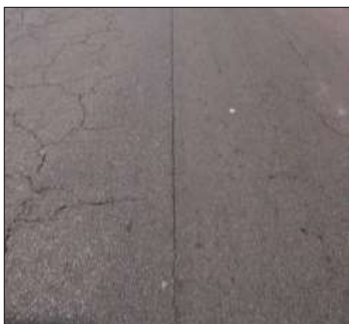
Figura 11: Fessura longitudinale da giunto di stesa.
