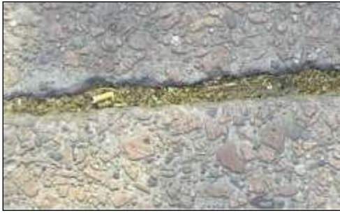
Figura 4: Degrado dei giunti non sigillati
