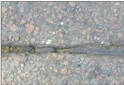
Figura 5: Degrado dei giunti precedentemente sigillati
