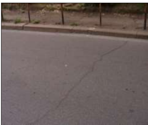
Figura 10: Esempio di fessura trasversale
