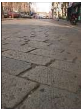
Figura 12: Eccessiva apertura dei giunti non sigillati
