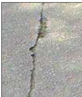
Figura 2: Esempio di fessurazione longitudinale
