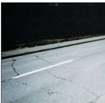
Figura 3: Esempio di fessurazione trasversale
