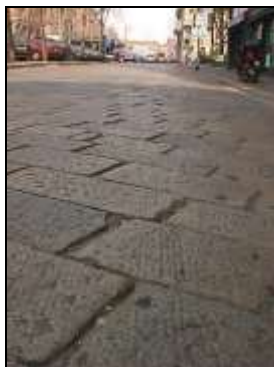
Figura 12: Eccessiva apertura dei giunti non sigillati
