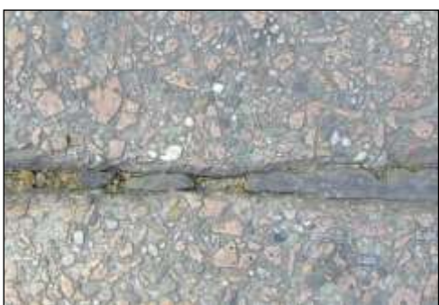
Figura 5: Degrado dei giunti precedentemente sigillati
