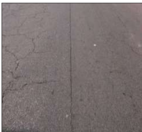
Figura 11: Fessura longitudinale da giunto di stesa.
