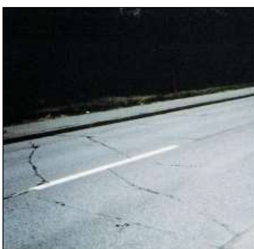
Figura 3: Esempio di fessurazione trasversale
