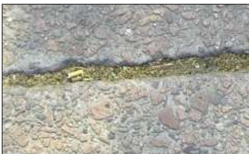
Figura 4: Degrado dei giunti non sigillati
