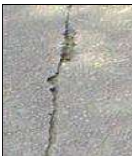
Figura 2: Esempio di fessurazione longitudinale
